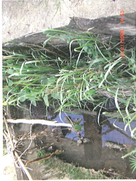
Sagrado Corazón – Calle Santa Brígida – descarga al canal obstruida por vegetación
