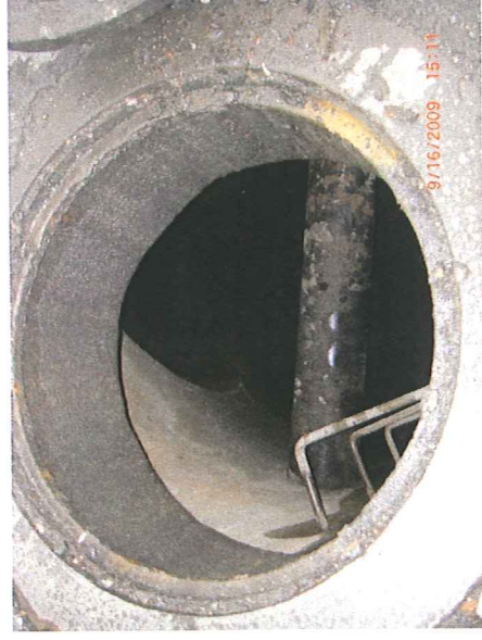
Villa Nevárez – Int. Calle 5 y Calle 24. Tubo cruzando la estructura.
