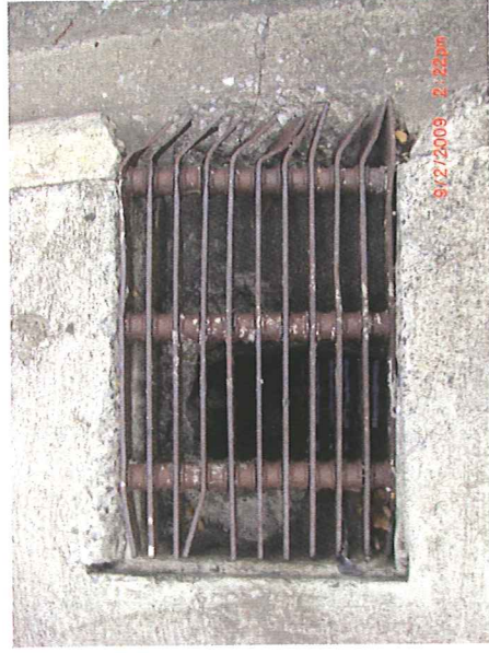
Sector Juan B. Huyke – Calle Fernando I. Estructura sanitaria con parrilla pluvial
