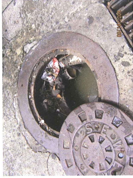
Sistema combinado en la Calle William Jones en el sector Rio Piedras.
